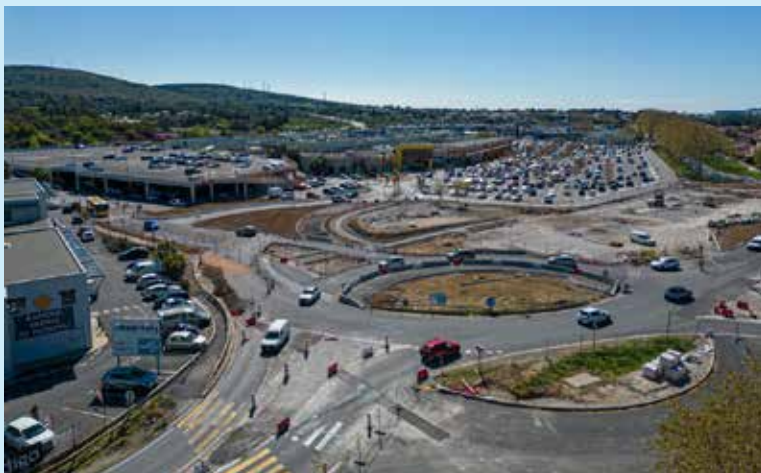
Ci-contre, les travaux de la gare routière multimodale de Balaruc-le-Vieux mise en service en novembre 2023.
