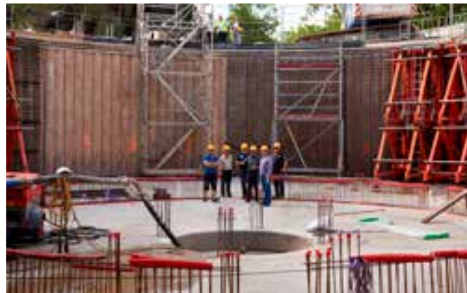
Bassin de rétention à Marseille
